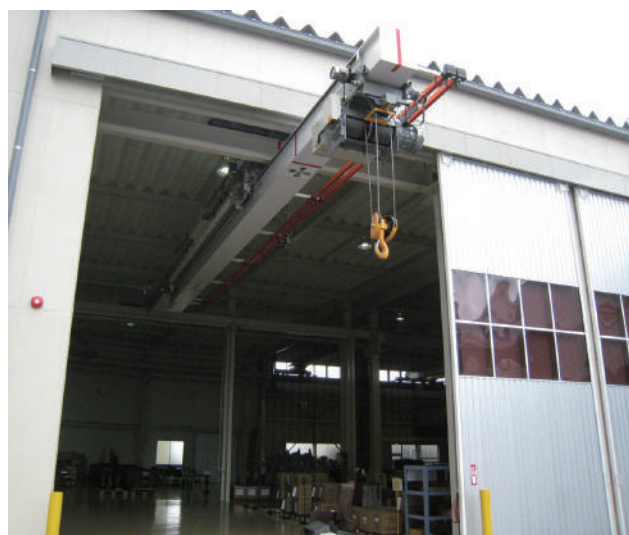
伸縮式天井クレーン
