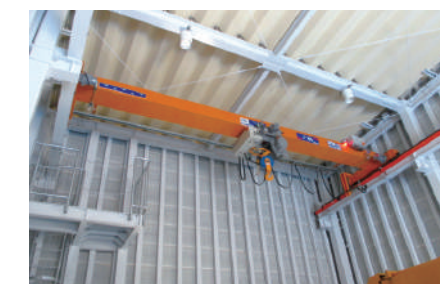
2.8t×SP6.7m天井クレーン
