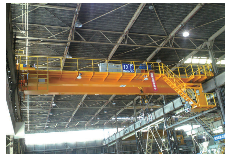
12t×17.1mクラブトロリ式天井クレーン
