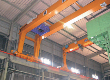
ケタカン・脚付天井クレーン
