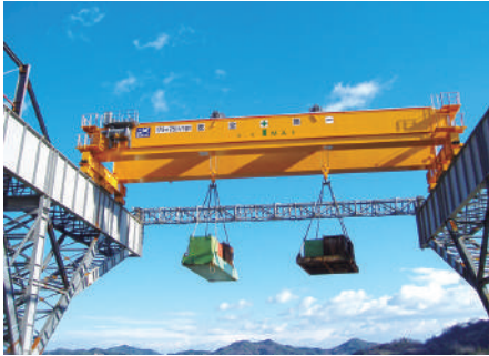
75t+75t/10t×29m 天井クレーン
