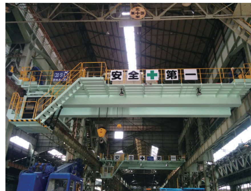
(20/5) t×SP15.028m天井クレーン
