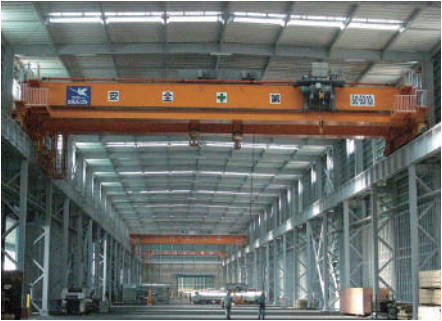
50t+50t/10t 天井クレーン
