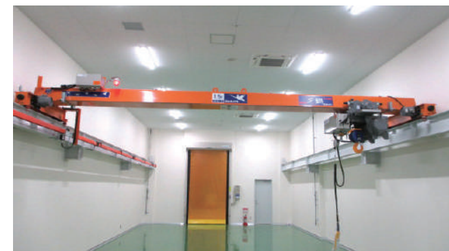
1.5t×SP6.4m天井クレーン
